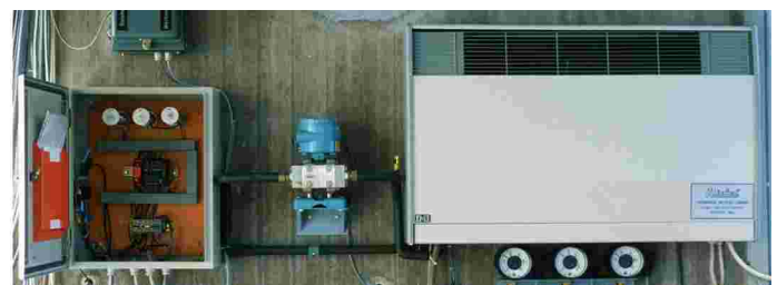
Bild 5: Kühlseitige Aggregate des Kühlgeräts mit Anlaßsteuerung, Durchflußmeßgerät, Verdampfer und Druckmeßstellen
