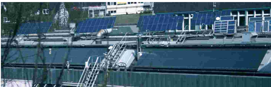
Bild 3 Solargeneratorfeld (oben) und HT-Vakuumröhrenkollektorfeld (Mitte) als Antrieb der solaren Kühlanlagen
